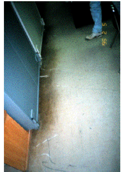
地震の揺れで校長室の金庫が動き、床に傷をつけた。
